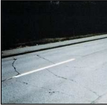
Figura 3: Esempio di fessurazione trasversale
