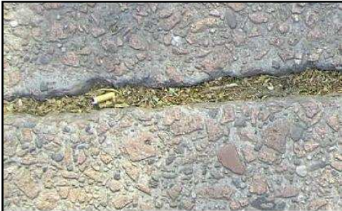
Figura 4: Degrado dei giunti non sigillati
