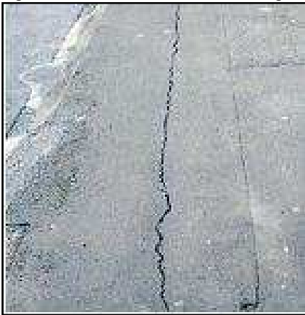
Figura 8: Esempio di fessura longitudinale
