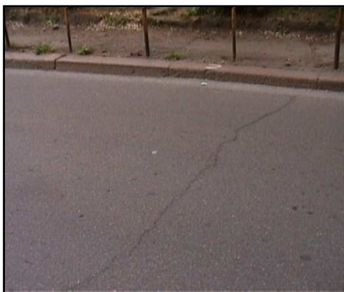
Figura 10: Esempio di fessura trasversale
