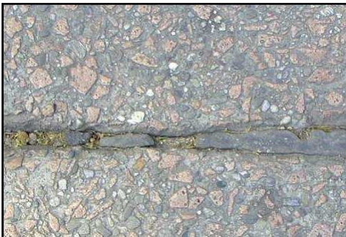
Figura 5: Degrado dei giunti precedentemente sigillati
