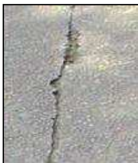
Figura 2: Esempio di fessurazione longitudinale
