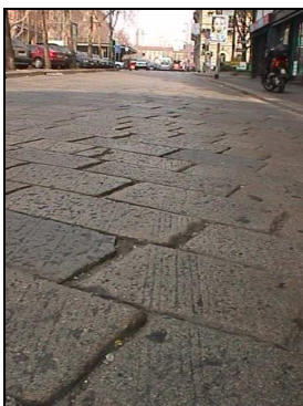
Figura 12: Eccessiva apertura dei giunti non sigillati
