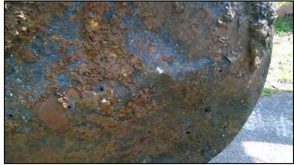
Foto 4: buchi nel serbatoio 4
