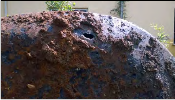
Foto 3: buchi nel serbatoio 1
